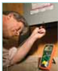
Mesure de la température interne d'un transformateur triphasé
