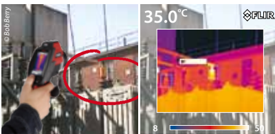
Inspection d'un transformateur au moyen de la fonction Fusion Image dans l'image.
