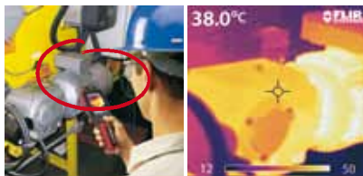
Vérification mécanique d'un moteur électrique au moyen de la FLIR i60.
