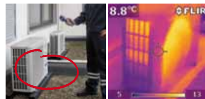
Vérification rapide et facile d'une installation de climatisation.
