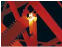
Connexion mal assurée
