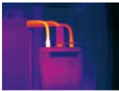
Mauvaise connexion et détérioration interne
