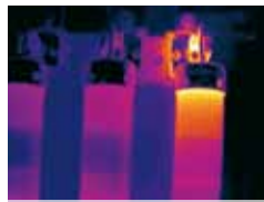
Détérioration interne du fusible
