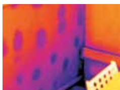
L'image thermique montre de la moisissure sur le mur intérieur, causée par une infiltration d'eau.
