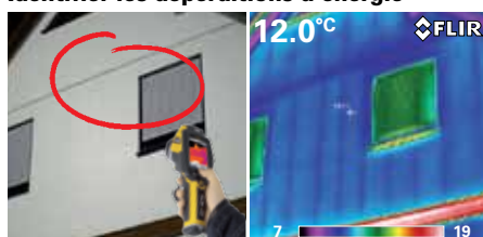
L'inspection par thermographie permet de voir un défaut d'isolation du mur.
