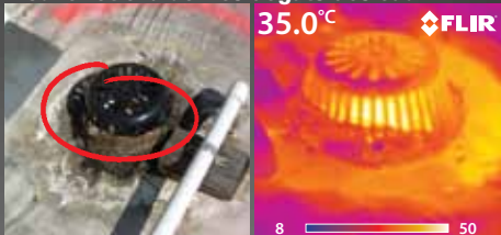
L'image thermique montre une fuite d'eau dans le toit.
