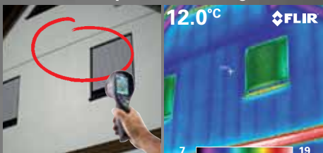
L'inspection par thermographie permet de voir un défaut d'isolation du mur.
